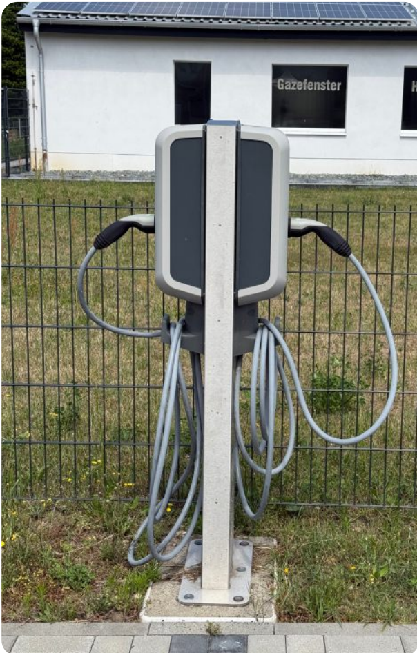
Details Wallbox / E-Auto Ladesäule
